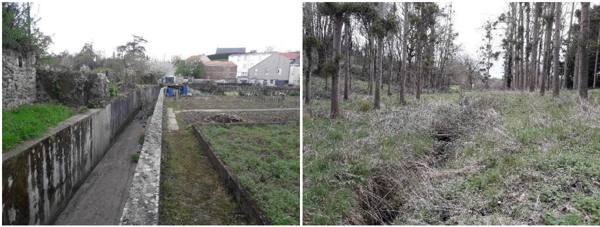
Figure 163 : Situations dégradées - Source : HARDY ENVIRONNEMENT
