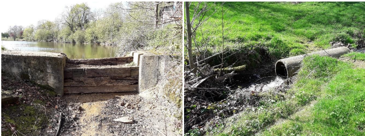
Figure 156 : Situations dégradées – Source : HARDY ENVIRONNEMENT
