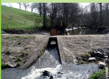
Ouverture des vannes (Beuvron)
